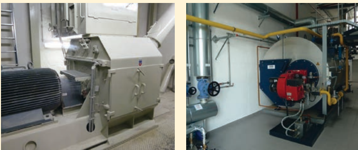
Abb. 5 Hammermühle und Satttdampferzeugung
